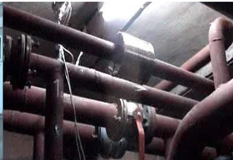
На выпускной трубе горячей воды PT- 50DS
